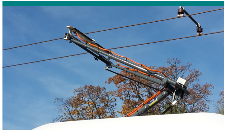
Abbildung 4: Konduktive Ladung mithilfe eines zweipoligen Stromabnehmers. Dieser sollte perspektivisch ortsfest an der Ladestation und nicht auf dem Fahrzeug montiert sein, um die Fahrzeugmasse zu verringern.
