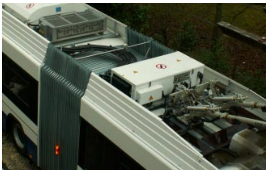
Klarer Verlegungsplan: Die Fahrzeugelektrik auf dem Dach.
