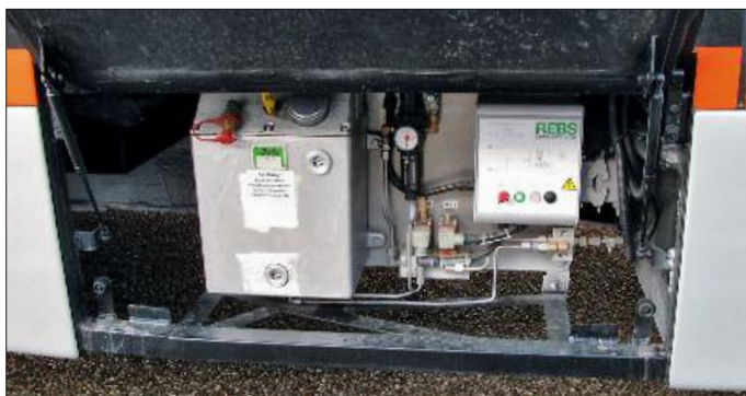
20. Das Rebs-Enteisungssystem für die Kontaktköpfe der Trolleystangen
