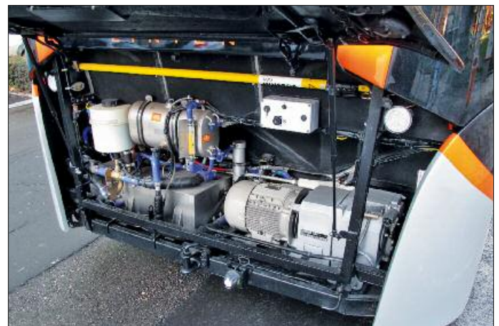
21. Heckklappe: Luftpresse und Teile der elektrischen Wasserheizung
