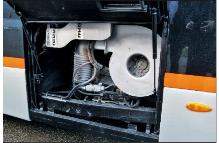
15. Luftkühlung der TSA-Motoren
