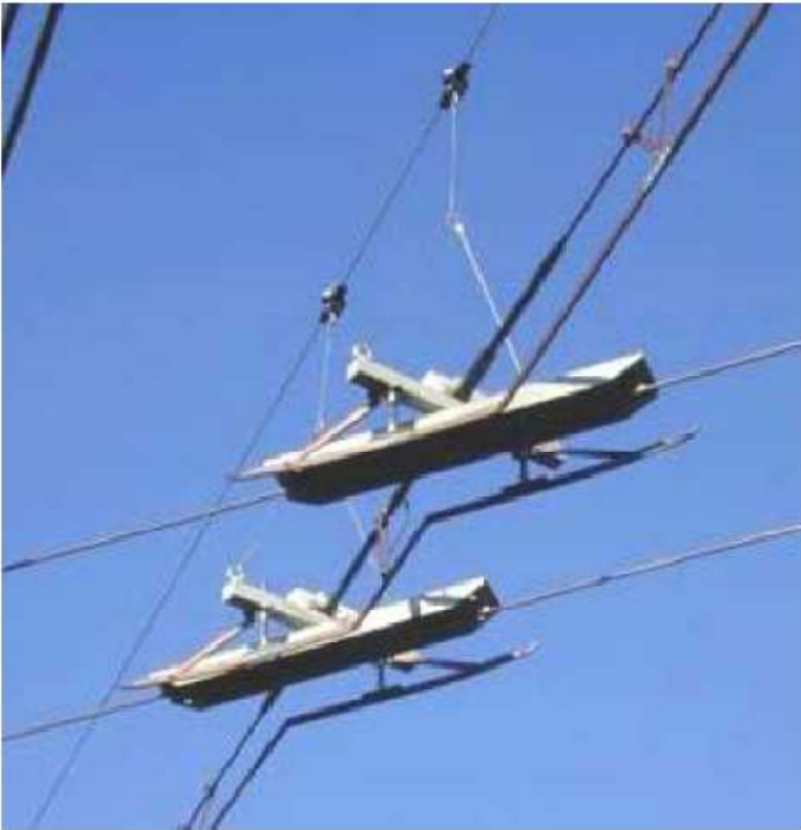
Abbildung 18. Kreuzung Obus/Straßenbahn ohne Stromunterbrechung
