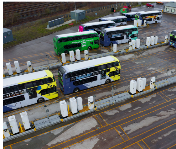
LEFT: Electric buses charging at Zajeźdźnia autobusowa Wola Duchacka in Krakow Poland.
